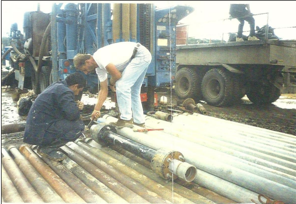
Tuberías galvanizadas y Packer
